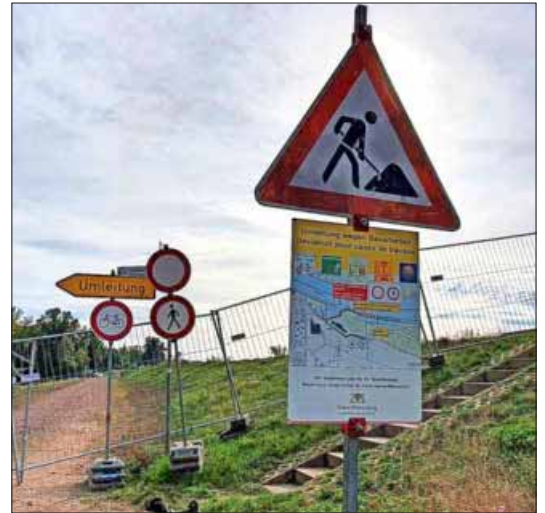
Ein Teil des Leinpfades in Richtung Breisach ist wegen der Polderbauarbeiten gesperrt.
